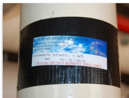
Tubería recubierta de amianto. Fuente: UEPG
